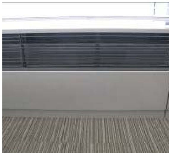
事務室 自然換気口
