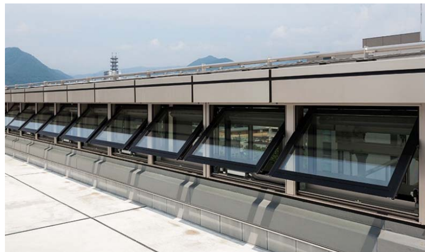
頂部: バランス式自然換気窓
