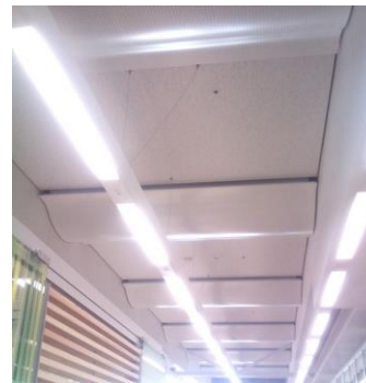
照明:過剰な照度, 不十分なゾーニング
