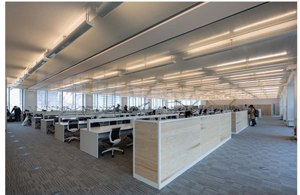
高層階ワークスペース 水冷媒天井放射空調システム
